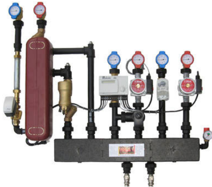
Die Fernwärmeübergabestation ersetzt die Heizung in den angeschlossenen Liegenschaften.
